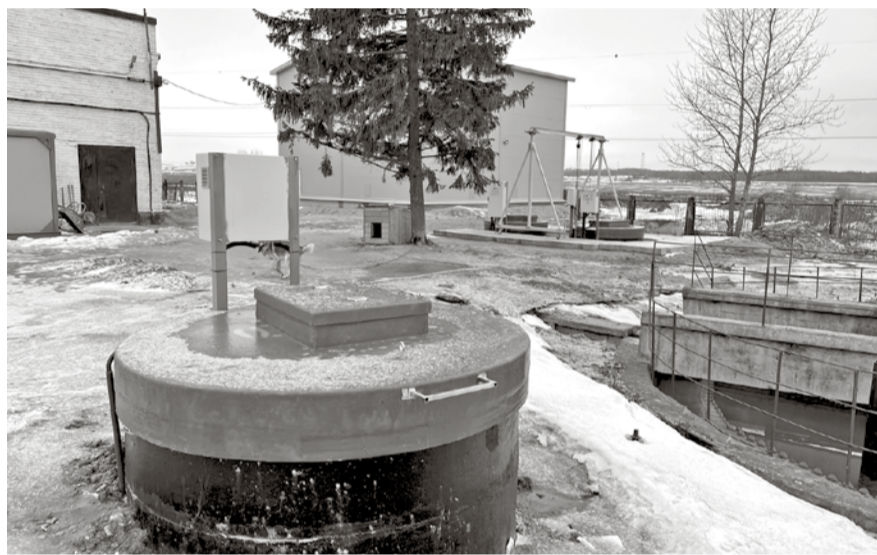
Канализационная насосная станция (КНС), подающая стоки на биофильтр
